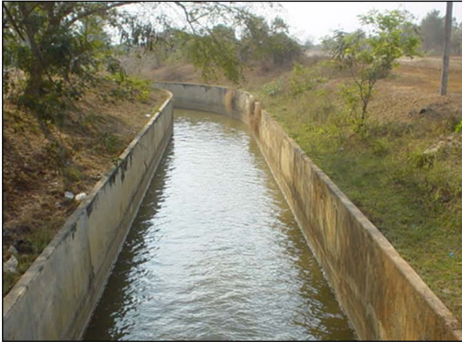
รางน้ำ (Bench Flume)
