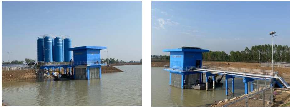
รูปที่ 4-4 สถานีสูบน้ำของโครงการปรับปรุงซ่อมแซมอ่างเก็บน้ำกุดนาแซง
