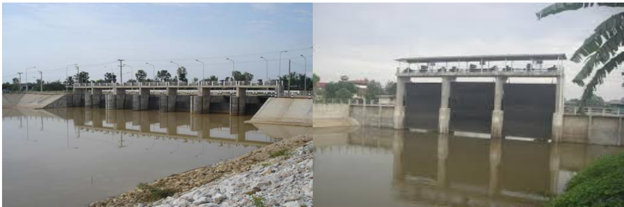
ประตูระบายน้ำ
