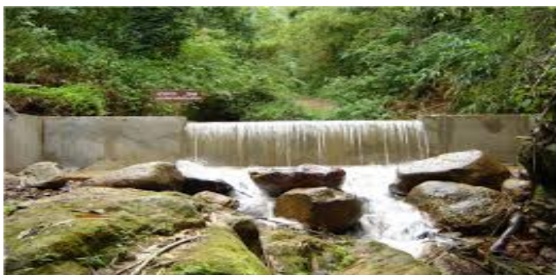
ฝายต้นน้ำลำธารแบบคอนกรีตเสริมเหล็ก
