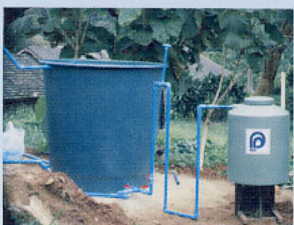
๑๑) ต่อท่อรักษาระดับน้ำหน้าทรายกรอง ประตุน้ำต่อท่อน้ำก๊อกน้ำเข้าถังเก็บน้ำดื่ม
