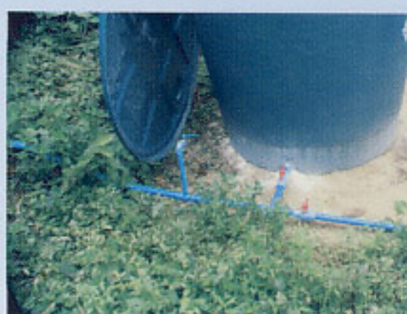
๑๒) ต่อท่อน้ำดิบประตุน้ำและก๊อกน้ำจากท่อน้ำล่าง เข้าสู่ระบบกรองน้ำดื่ม
