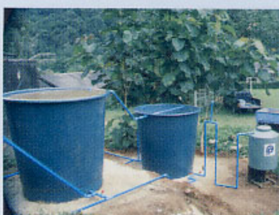
๑๔) เปิดน้ำเพื่อล้างทรายกรองระบายน้ำจนน้ำใสสะอาด ก็พร้อมที่จะเริ่มต้นทำงานระบบกรอง
