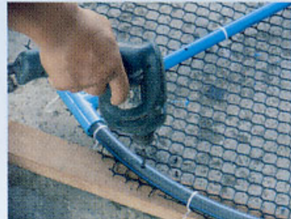
๖) เจาะรูท่อพีวีซี และท่อพีวีซี ที่ทำเป็นโครงตะแกรง เพื่อไม่ให้มีอากาศ และจมอยู่ใต้น้ำ
