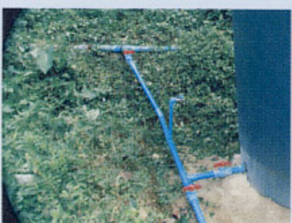
๑๓) เปิดน้ำเข้าสู่ระบบกรองน้ำดื่ม
