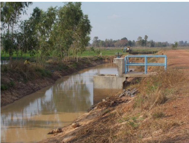
ประตูเปิด-ปิด ระบายน้ำ
