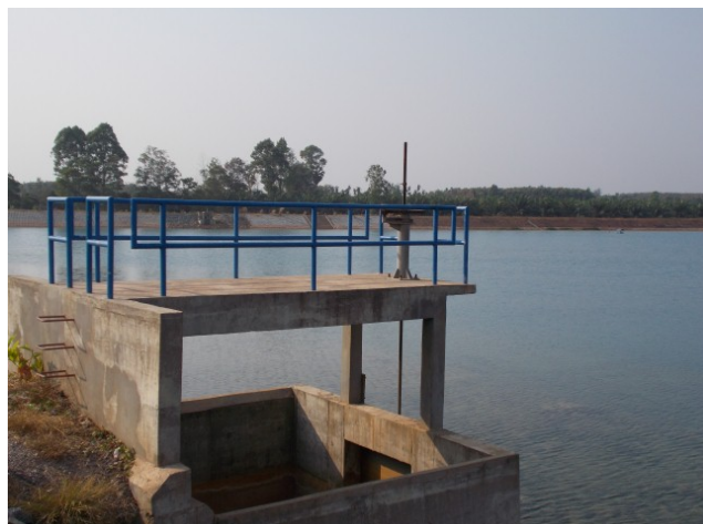
อาคารบังคับน้ำด้านหลังโครงการ
