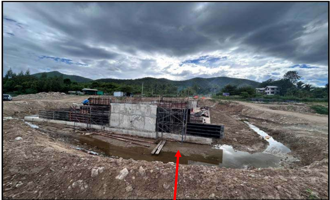
น้ำซึมบริเวณรอบหลุมโครงการฯ
