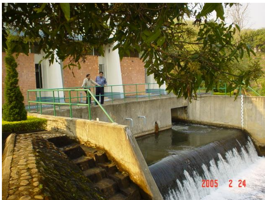
ทางออกท้ายน้ำ โครงการไฟฟ้าพลังน้ำแม่กิมหลวง อำเภอแม่ฮวย จังหวัดเชียงใหม่
