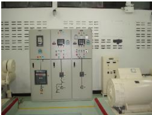
ตู้ควบคุมไฟฟ้า โครงการไฟฟ้าพลังน้ำแม่ต๋ืน
