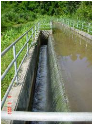
บ่อดักน้ำ โครงการไฟฟ้าพลังน้ำห้วยน้ำขุน
