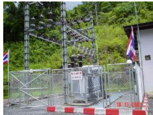
ลานโกไฟฟ้า โครงการไฟฟ้าพลังน้ำคลองลำปลอก
