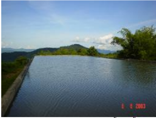
ถัง Regulating Tank โครงการไฟฟ้าพลังน้ำห้วยน้ำขุ่น
