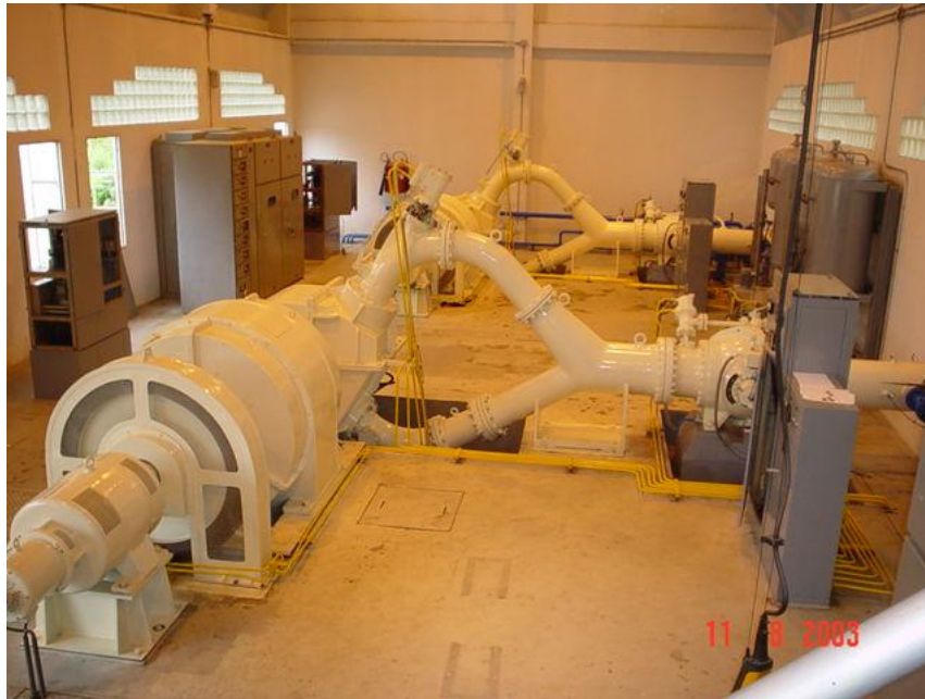
เครื่องกังหันน้ำและเครื่องกำเนิดไฟฟ้าพร้อมอุปกรณ์ โครงการไฟฟ้าพลังน้ำห้วยน้ำขุ่น จังหวัดเชียงราย
