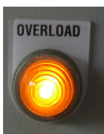
รูปที่ 53 หลอดไฟสีเหลือง
