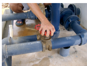
รูปที่ 58 เปิดประตูระบายน้ำทิ้งจากพื้นถังกรอง (ประตุน้ำหมายเลข 4)
