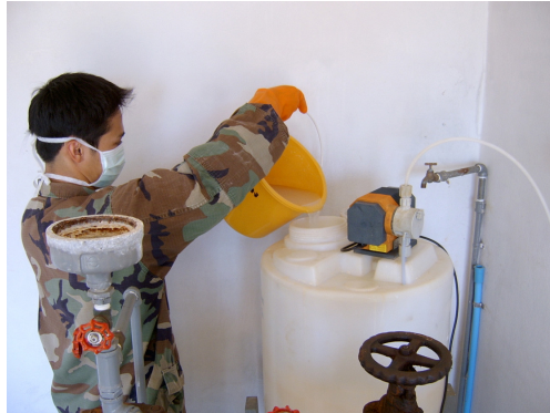
รูปที่ 32 การเติมสารละลายคลอรีนลงในถังจ่ายสารละลายคลอรีน
