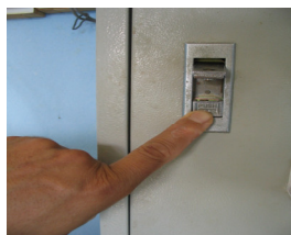
รูปที่ 41 ปุ่มเปิดประตูตู้ควบคุมเครื่องสูบน้ำดี
