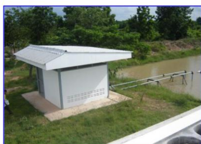
แหล่งน้ำดิบ / โรงสูบน้ำดิบและเครื่องสูบน้ำดิบ
