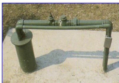
บ่อบาดาลและเครื่องสูบน้ำดิบ
