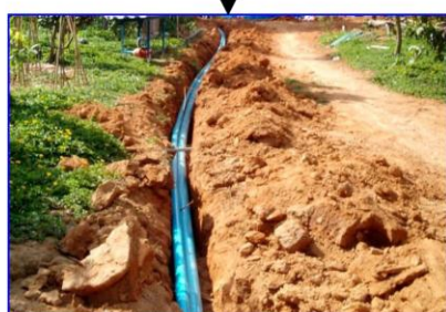
ท่อจ่ายน้ำ
