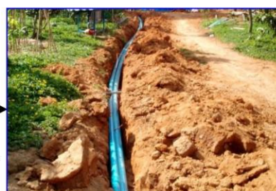
ท่อจ่ายน้ำ
