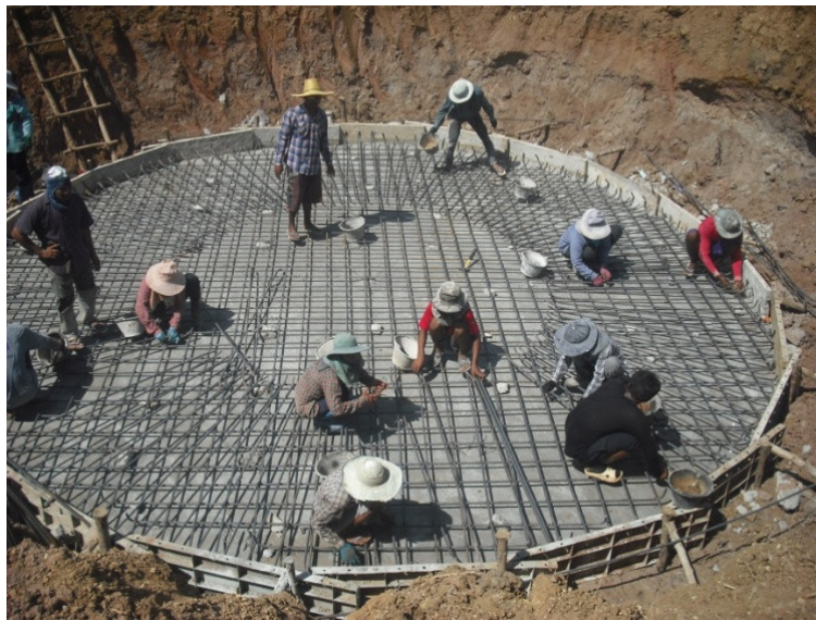
รูปที่ 25 การวางเหล็กเสริมฐานรากถึงน้ำใส
