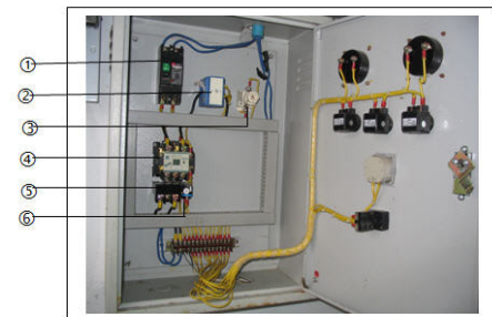
ลักษณะภายในตู้ควบคุม เครื่องสูบน้ำ (แบบหอยโข่ง)
