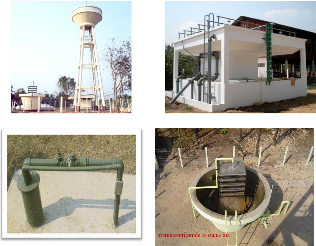
รูปที่ 81 ระบบประปาหมู่บ้านแบบบาดาลของกรมทรัพยากรน้ำ
