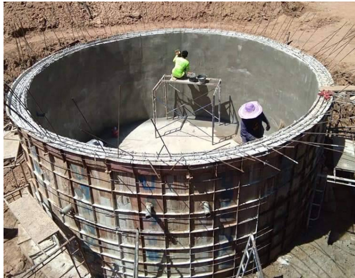
รูปที่ 73 งานคอนกรีตภายในส่วนที่สัมผัสน้ำ ฉาบสารกันซึม ชนิดซีเมนต์เบส
