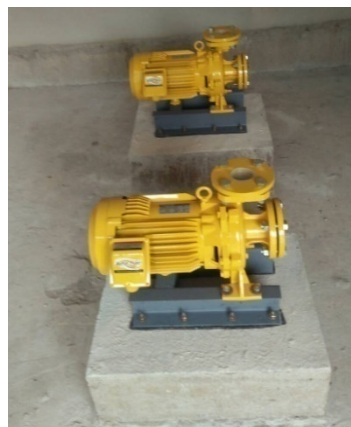
รูปที่ 74 งานแทนเครื่อง คสล. สำหรับติดตั้งเครื่องสูบน้ำฝักเหล็กสำหรับยึดกับแทนเครื่อง
