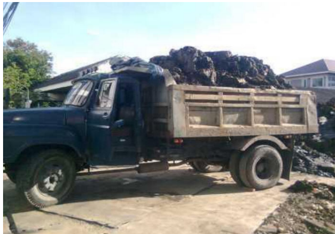
รูปที่ 3 การขนย้ายวัสดุที่ไม่ต้องการ ออกจากบริเวณที่ทำการก่อสร้าง
