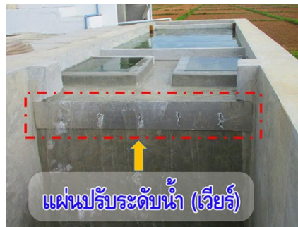
รูปที่ 77 งานติดตั้งแผ่นปรับระดับน้ำ (เวียร์)
