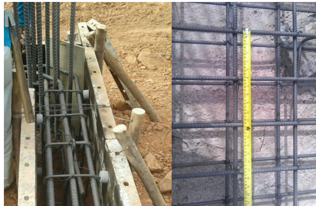
รูปที่ 17 การตรวจสอบเหล็กเสริม ค้ำยัน และการหนุนลูกปุน ก่อนการเทคอนกรีต
