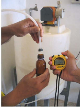
รูปที่ 59 การตรวจสอบปริมาณการจ่าย เครื่องจ่ายสารละลายคลอรีนโดยวิธีการตวงจับเวลา
