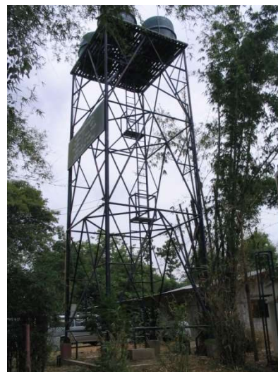
หอถังสูงเหล็กพร้อมถังไฟเบอร์กลาส
