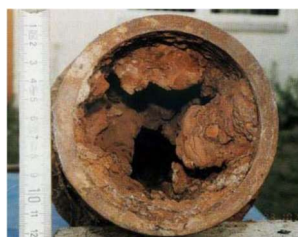
ท่อส่งน้ำอุดตัน
