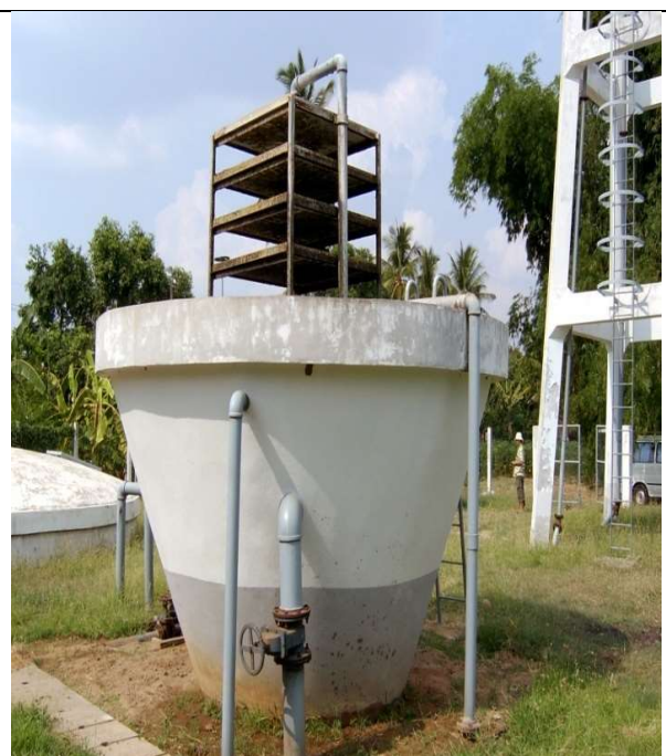
รูปที่ 7-2 ถังกรองบาดาลขนาดใหญ่
