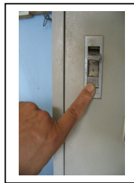
รูปที่ 8 ปุ่มเปิดประตูตู้ควบคุมเครื่องสูบน้ำดิบ
