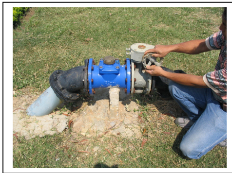
รูปที่ 62 เปิดประตูน้ำจ่ายน้ำประปา (ประตูน้ำหมายเลข 1)
