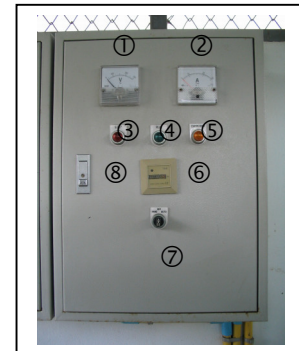
ลักษณะภายนอกตู้ควบคุม เครื่องสูบน้ำดิบ (แบบจมน้ำ)
