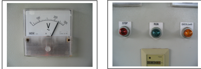
รูปที่ 46 โวลท์มิเตอร์ และหลอดไฟสีแดง, สีเขียว และสีเหลือง
