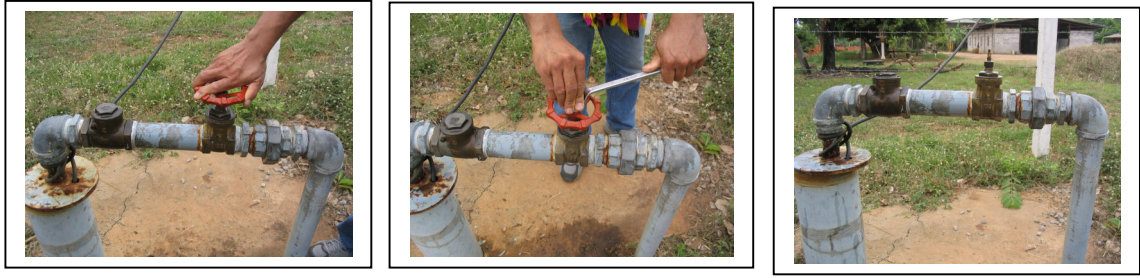
รูปที่ 21 การปรับประตูจ่ายน้ำเข้าสู่ระบบกรองและประตูจ่ายน้ำที่ถอดพวงมาลัยแล้ว
