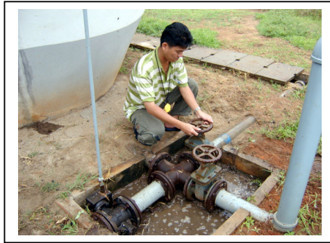
รูปที่ 57 เปิดประตูระบายน้ำทิ้งจากพื้นถังกรอง (ประตูน้ำหมายเลข 4)
