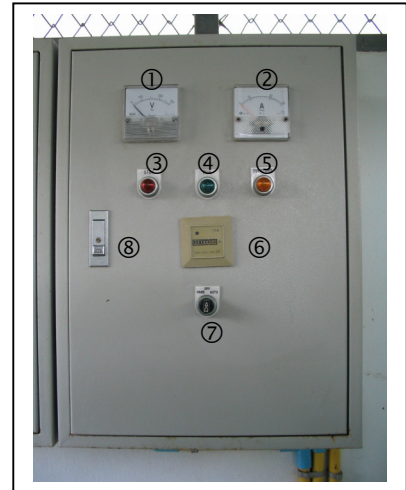
ลักษณะภายนอกตู้ควบคุม เครื่องสูบน้ำดี (แบบหอยโข่ง)
