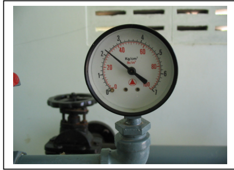
รูปที่ 51 เข็มของเกจวัดแรงดันจะแสดงการทำงานของเครื่องสูบน้ำดี
