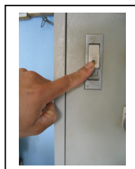
รูปที่ 10 ปุ่มปิดประตูตู้ควบคุมเครื่องสูบน้ำดิบ
