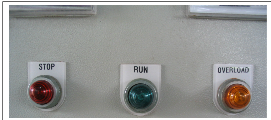
รูปที่ 11 โวลท์มิเตอร์ และหลอดไฟสีแดง, สีเขียว และสีเหลือง
