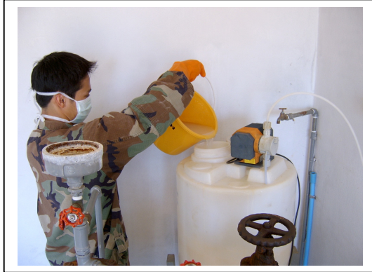
รูปที่ 34 การเติมสารละลายคลอรีนลงในถังจ่ายสารละลายคลอรีน
