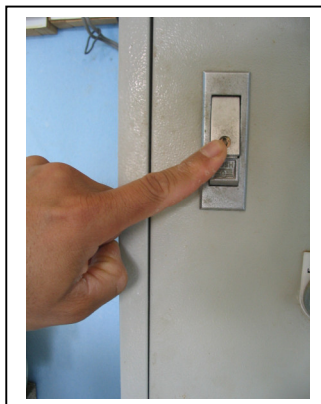
รูปที่ 45 ปุ่มปิดประตูตู้ควบคุมเครื่องสูบน้ำดี
