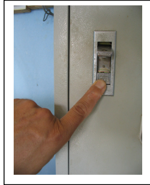
รูปที่ 43 ปุ่มเปิดประตูตู้ควบคุมเครื่องสูบน้ำดี
