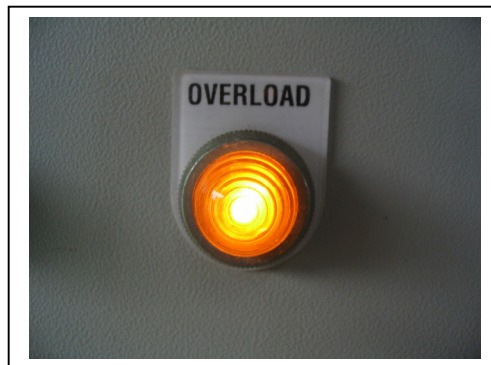
รูปที่ 52 หลอดไฟสีเหลือง
