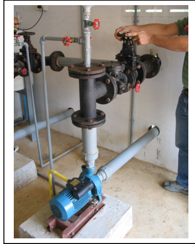
รูปที่ 60 ปิดประตูน้ำด้านท่อจ่ายน้ำของเครื่องสูบน้ำดี
