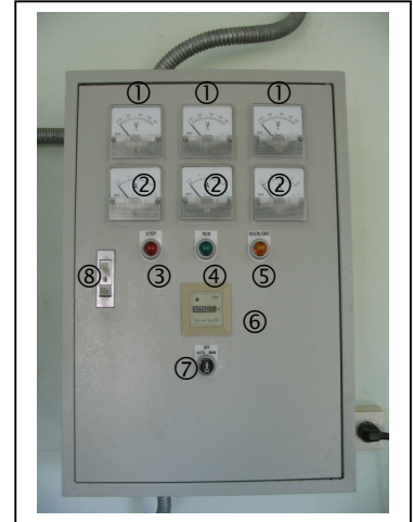
ลักษณะภายนอกตู้ควบคุม เครื่องสูบน้ำดี (แบบหอย
