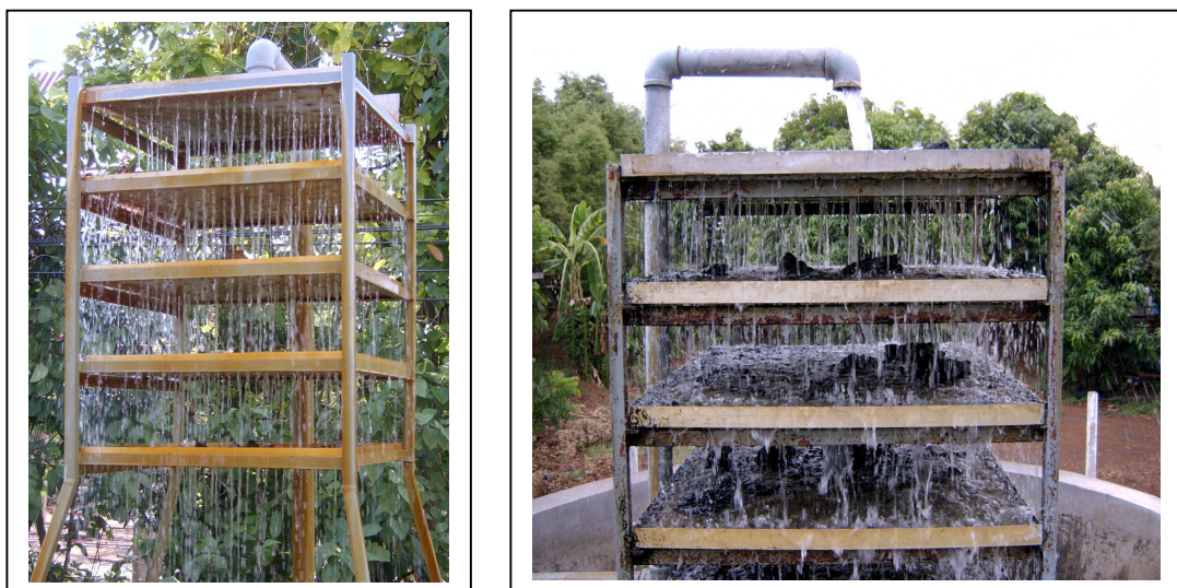
รูปที่ 22 ระบบเติมอากาศ
