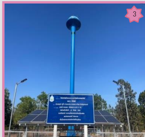
โครงการระบบกระจายน้ำด้วยพลังงานแสงอาทิตย์ ขนาด 4 กิโลวัตต์ แหล่งน้ำหนองแดง
